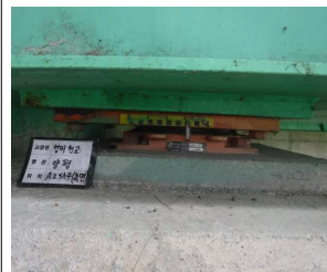
④ 양평, 마산방향 교대측 교량반침 가동 여유량 부족
