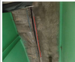
③ 양평, 마산방향 바닥판 하면 균열(폭 0.3mm, 들뜸) 및 박락
